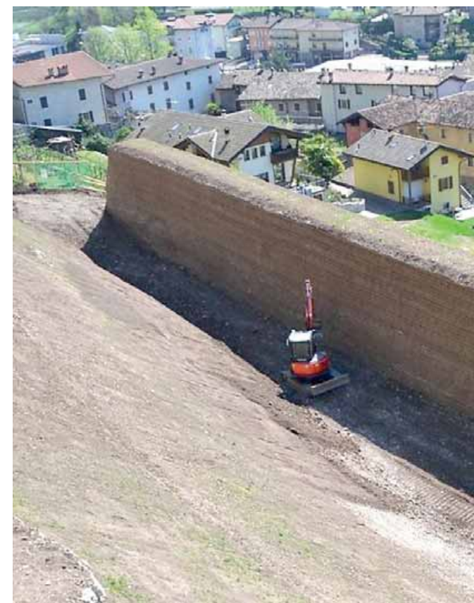
Una fase dei lavori per il vallo tomo a protezione del centro di Mori
